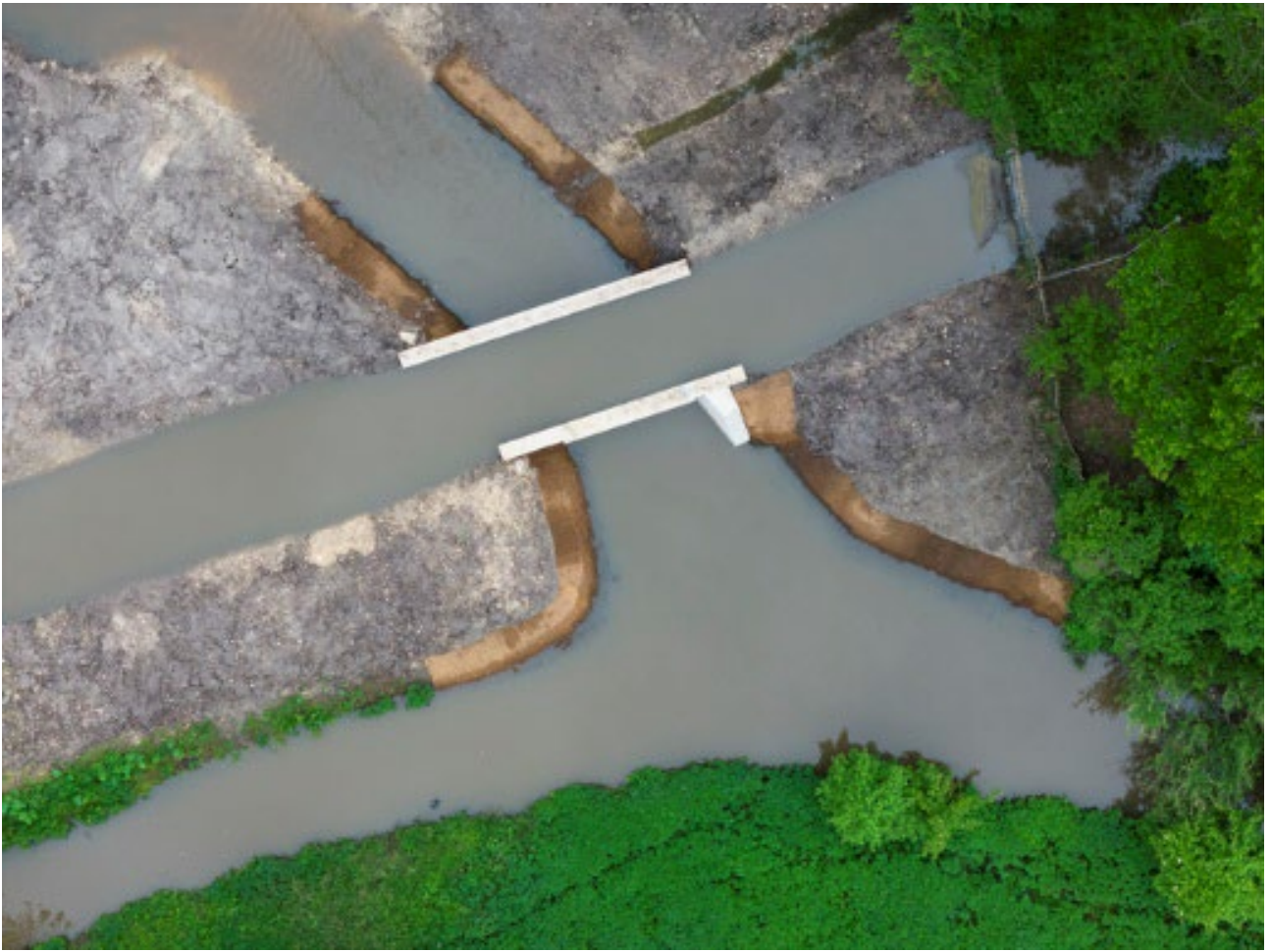
Le site du pont-canal du château de Fougères-sur-Bièvre à la fin des travaux © C. Ananiguan - CMN
